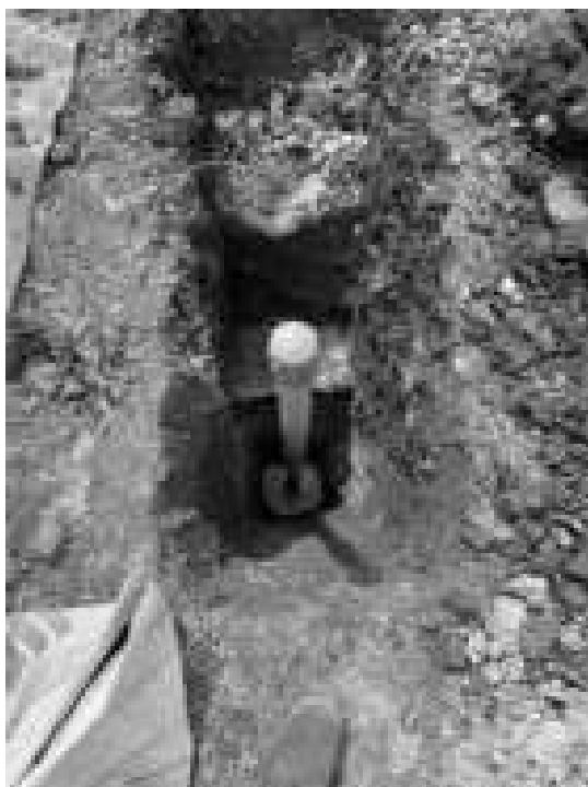
Ilustración 2. Instalación de Freatímetro
