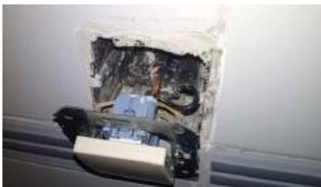
Figura 8. Enchufes eléctricos inseguros en las oficinas administrativas Haro, 2021
