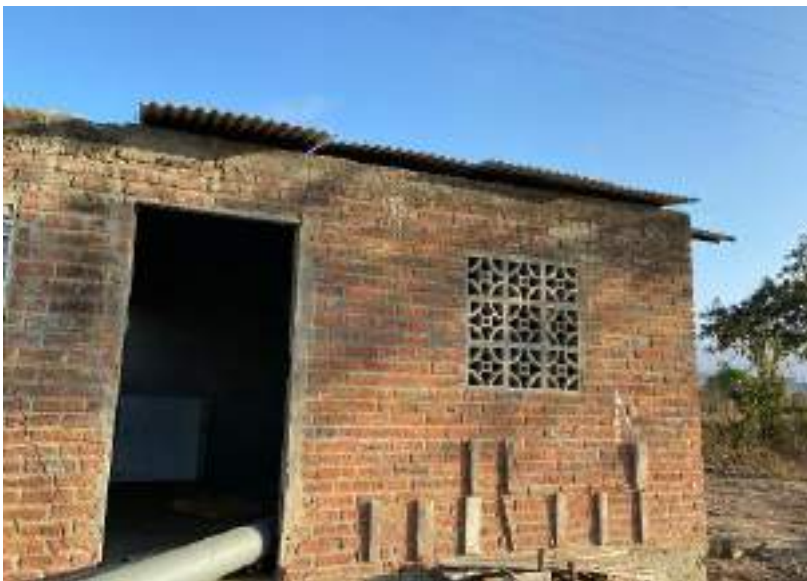
Figura 3. Cuarto de bombas de riego que presenta una estructura insegura y en mal estado Haro, 2021
