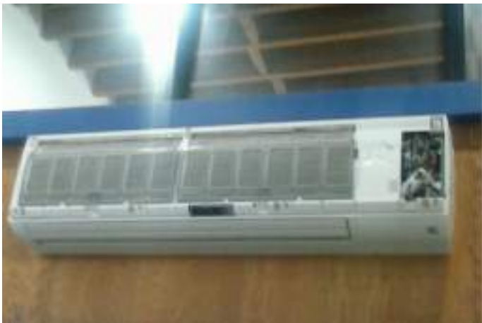
Figura 10. Falta de mantenimiento periódico en los aires acondicionados de las oficinas administrativas Haro, 2021
