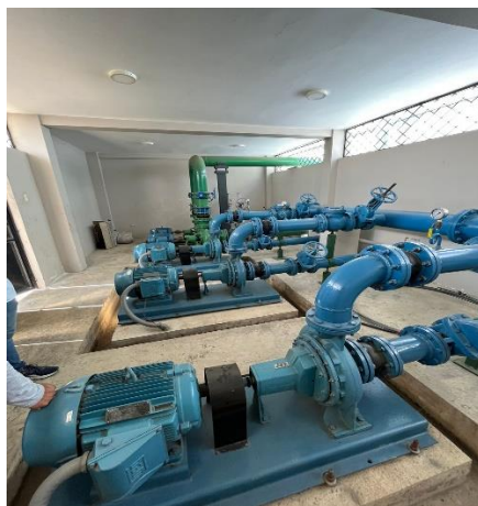
Figura 13. Bombas de abastecimiento de agua potable al canton Alfredo Baquerizo Moreno
