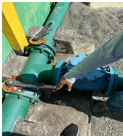
Figura 7. Llaves de paso de captación de agua
