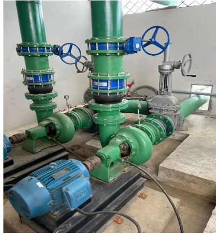
Figura 5. Bombas de captación de agua del pozo
