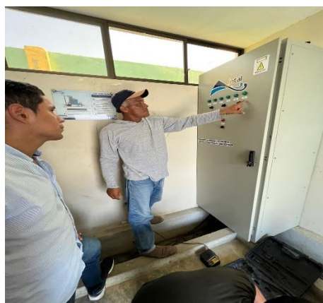
Figura 4. Panel de control de encendido y apagado de las bombas
