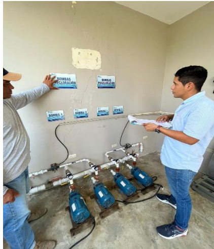
Figura 12. Cuarto de bombas pre y post cloración
